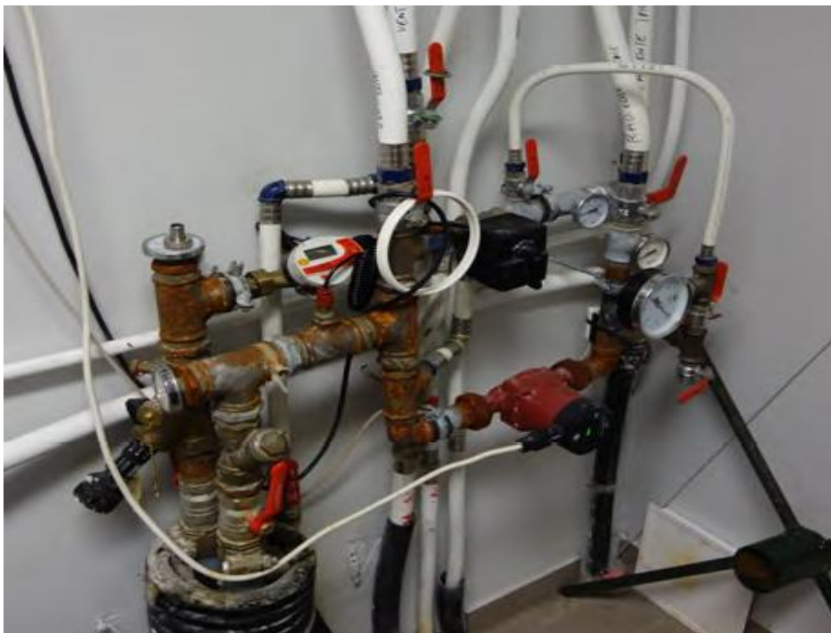
Joonis 11. Kääpa lasteaia-teeninduskeskuse soojussõlm
